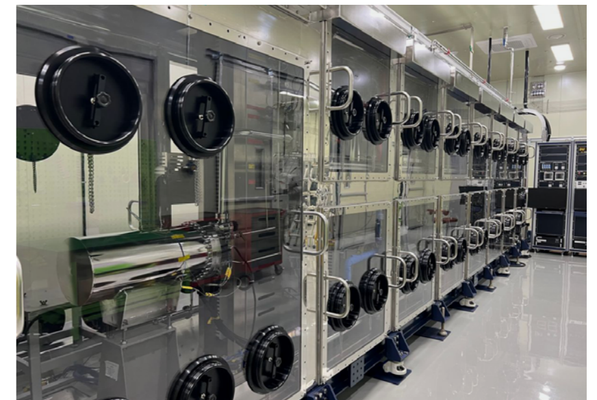
성능 검증시험용 우라늄 수소 저장용기(DU FB)와 공정성능 검증시험 장치(DU-SPOVE)
